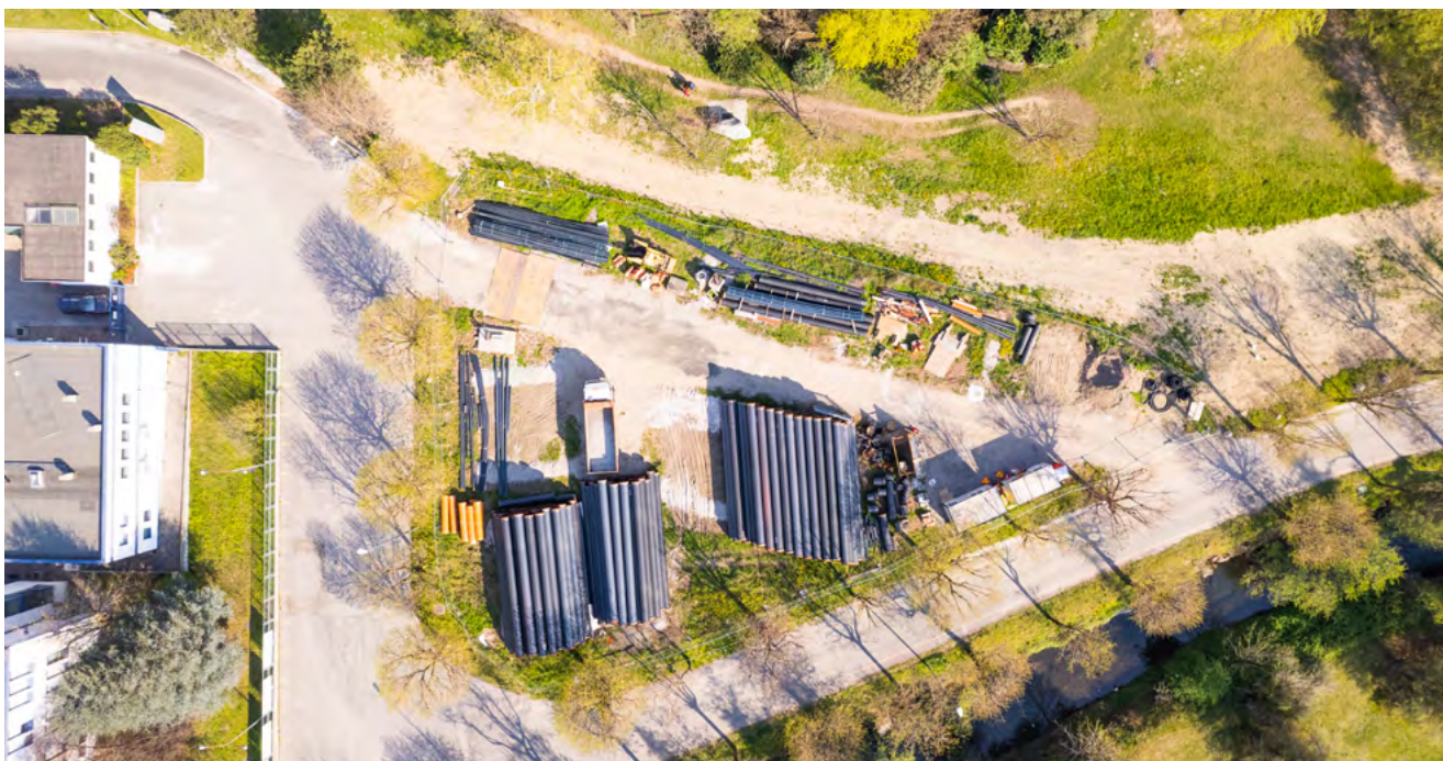
Deposito delle tubazioni per il raddoppio dell'Acquedotto Brianteo, Valmadrera. Foto di Matteo Colombo
