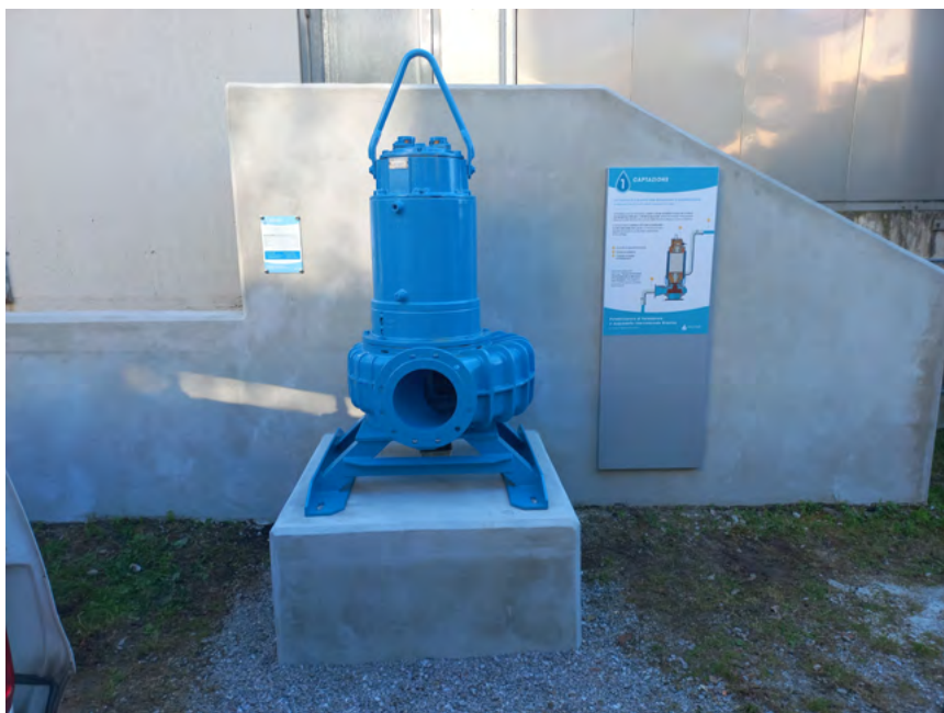
Cartellonistica esplicativa presso l'impianto di potabilizzazione di Valmadrera.
