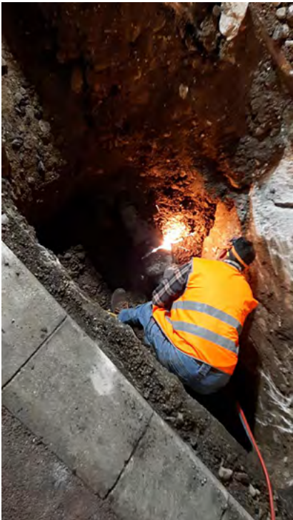
Riparazione di una perdita notturna in Via Tonio da Belledo, Lecco. Foto di Matteo Paleari.
